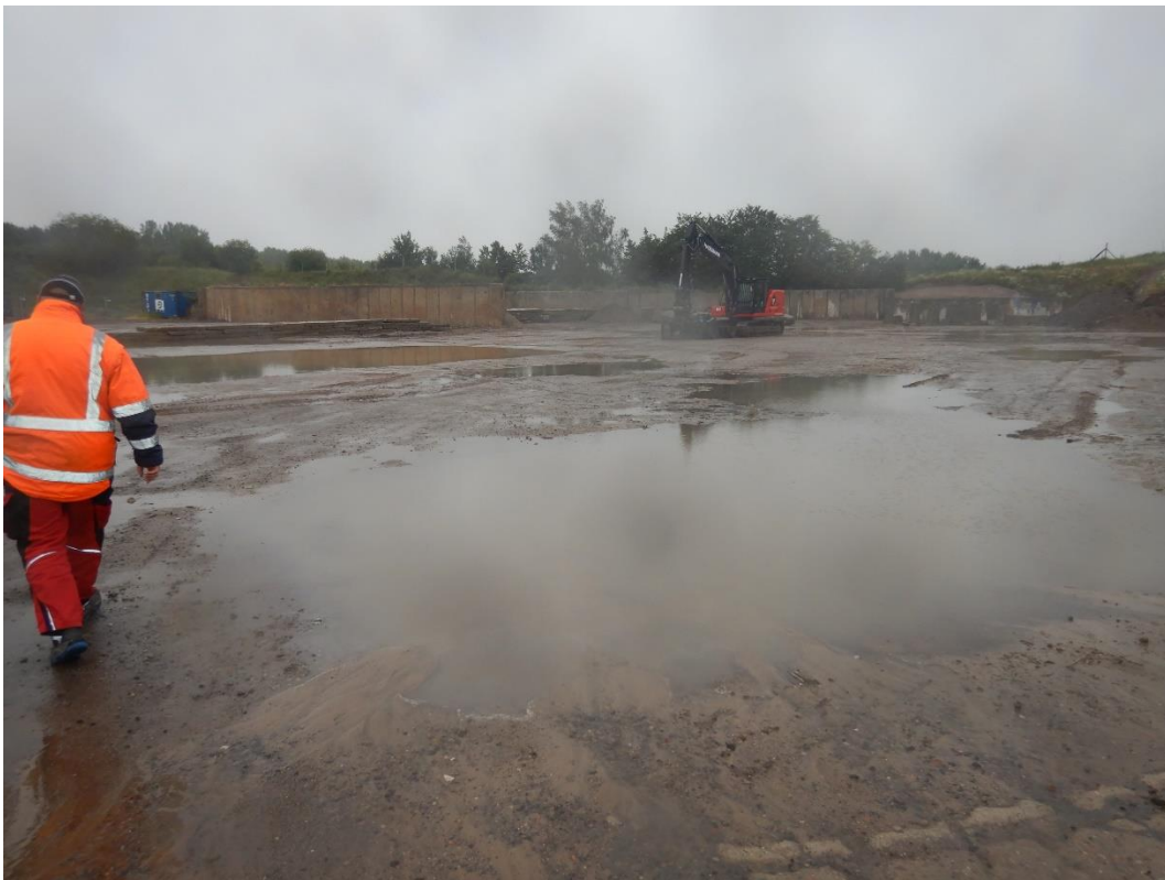
Abbildung 1-1: Die Situation auf dem Grundstück der Hagemann GmbH in Broderstorf während eines Regenerignisses am 10.07.2020 verdeutlicht, dass das bestehende Entwässerungssystem nicht mehr funktionsfähig ist.
